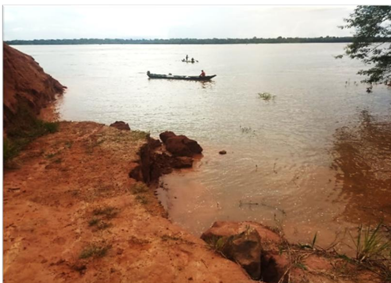
Figura 7. Risco de solapamentos de terras
