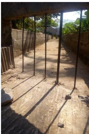
Figura 12: Valas de drenagem precárias são construídas pelos munícipes para mitigação do problema.
